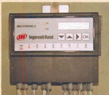
Abb. 2 Zur Steuerung der gesamten Druckluftstation wird eine Multitronic von Ingersoll-Rand eingesetzt Foto: Ingersoll Rand
