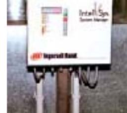
Die zentrale Intellisys-Steuerung schaltet die einzelnen Kompressoren bedarfsgerecht zu bzw. ab
