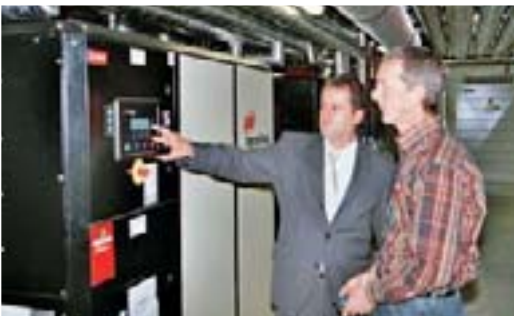
Im Gespräch vor Ort: Bernd Wolfering, Leiter der Technikabteilung der Rottendorf Pharma GmbH (rechts), und Klaus Brodessa, Gebietsleiter von Ingersoll Rand Air Solutions, in der Druckluftzentrale von Rottendorf.
